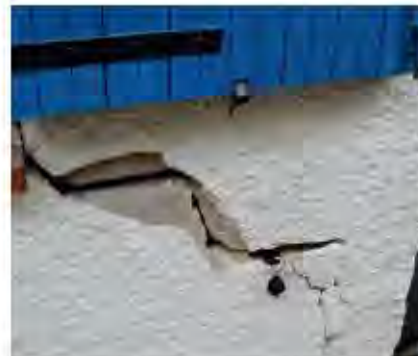
Maison fissurée dans le Pas-de-Calais, août 2009. Sources : BRGM - P. BACH
